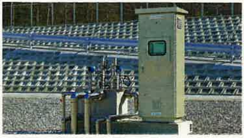
■モニタリング設備
