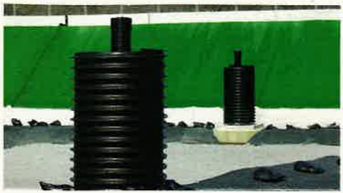
■集水・ガス抜き設備
