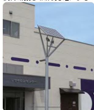
例) 太陽光+風力発電によるLED外灯
